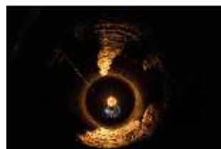
NbgKbg.II, Tiefer Brunnen, DI000509, BSV
